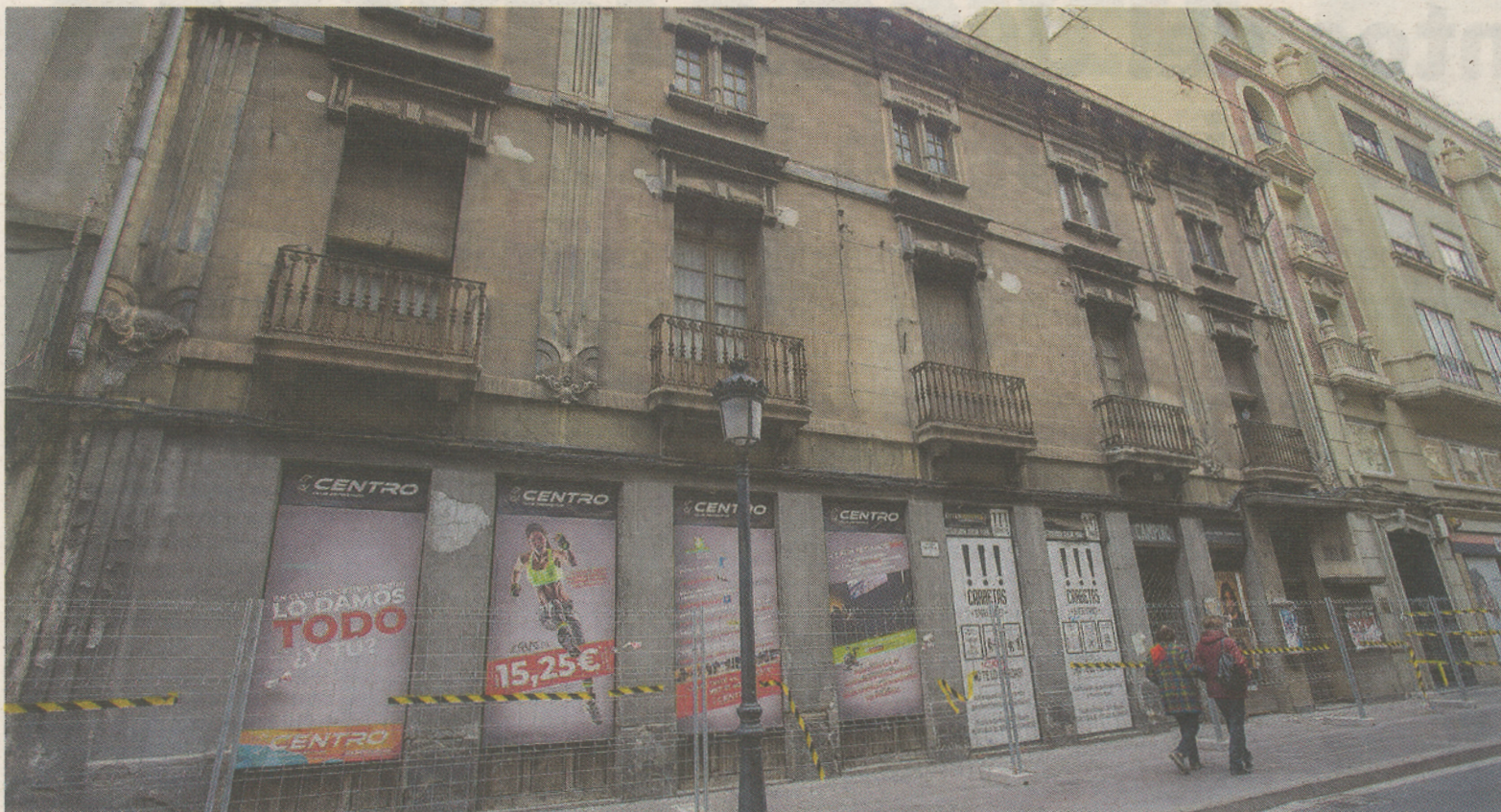
Una valla junto a la fachada del inmueble ubicado en la calle Ancha alerta de su deterioro. / JOSÉ MIGUEL ESPARCIA
