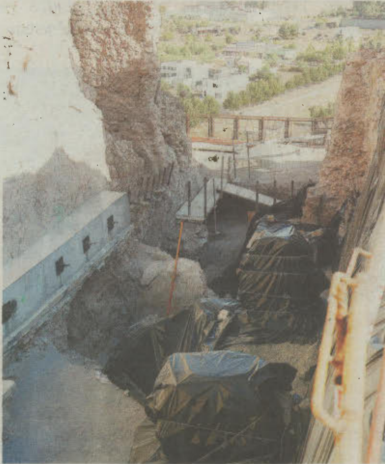
Restos en la zona de los cimientos del derruido muro norte del Castillo. / LUIS BONETE
