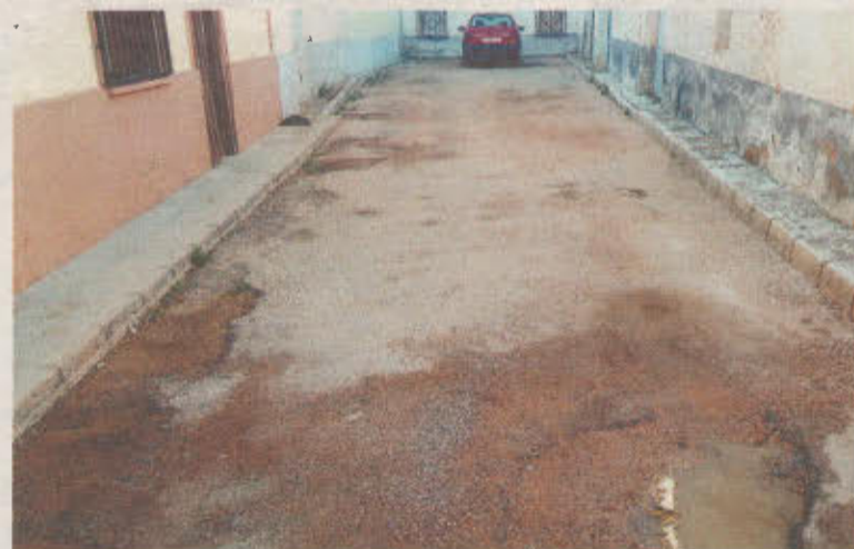
Estado que presenta una de las calles que piden arreglar en Santa Ana. / PSOE
