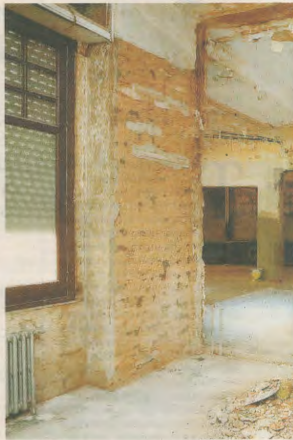
Las instalaciones están deterioradas. / J.M.E.
