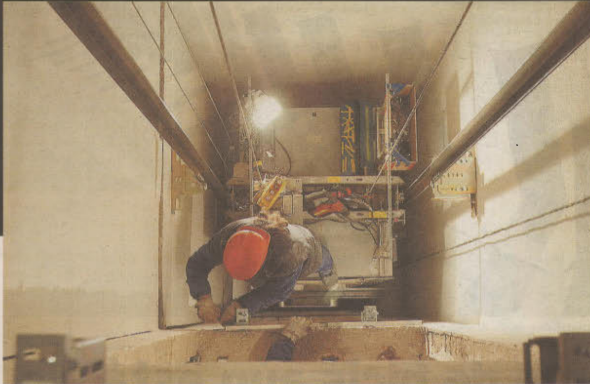
Obras en una comunidad en la que se ha instalado un ascensor. / L.L.A.
